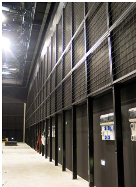
Hangnyelő burkolat és tartó/védőrács a festett oldalfal előtt.
